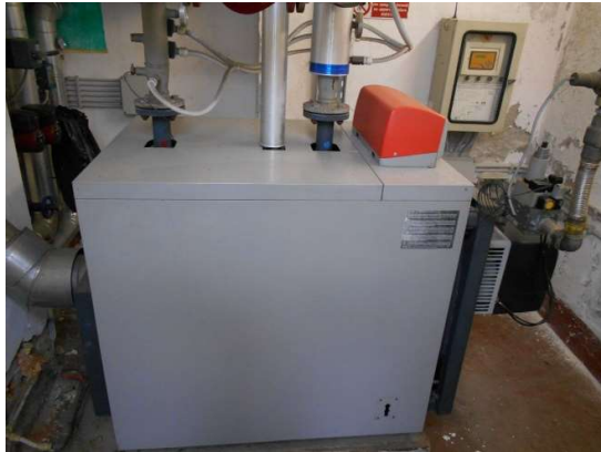
Figura 8.7 - Particolare del generatore di calore
