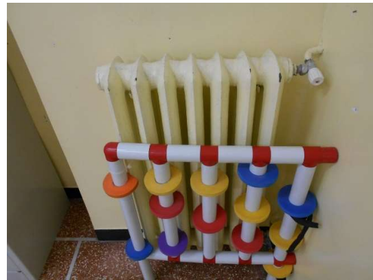
Figura 8.8 - Particolare di un radiatore
