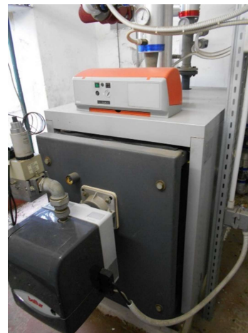
Figura 4.11 - Particolare della caldaia
