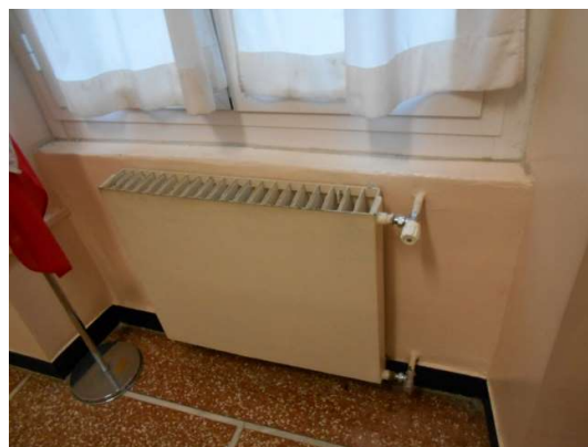
Figura 4.8 - Particolare di un radiatore in ghisa
