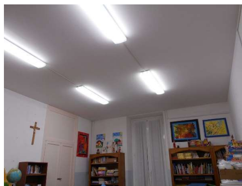
Figura 8.10 - Particolare di una plafoniera a tubi fluorescenti
